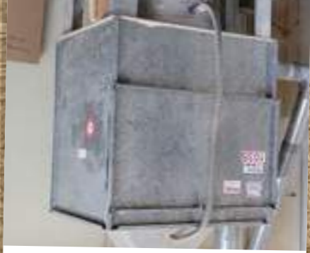
ABSUGANLAGE Scheibe 14.2 Baujahr: 1991 Art.-Nr.: AE-P-23018
